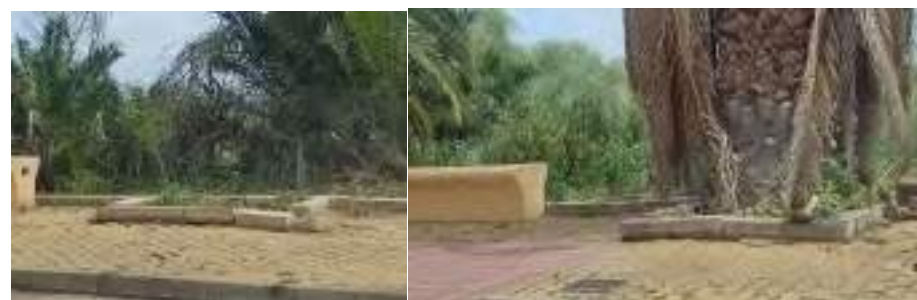
Ilustración 22. Alcorques sin reponer y estado del acerado. Avda. Ría Carreras. Isla Cristina. Elaboración propia (junio 2022)
